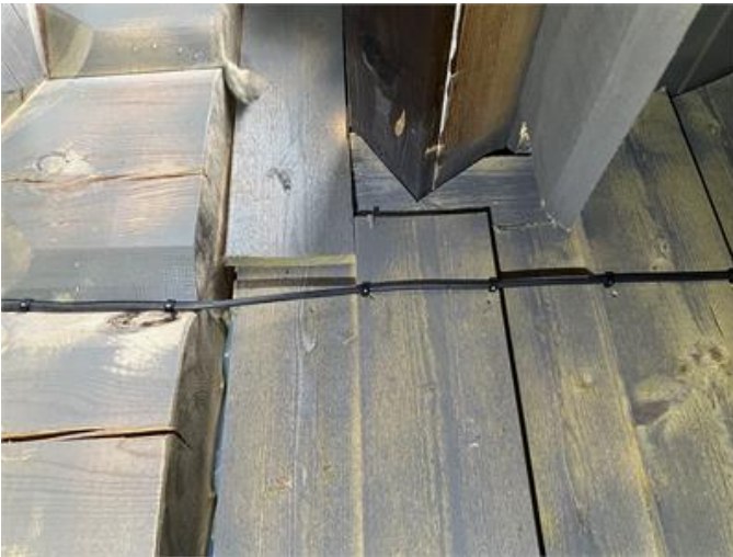
Väggskarv mellan fasadpanel och timmer.
