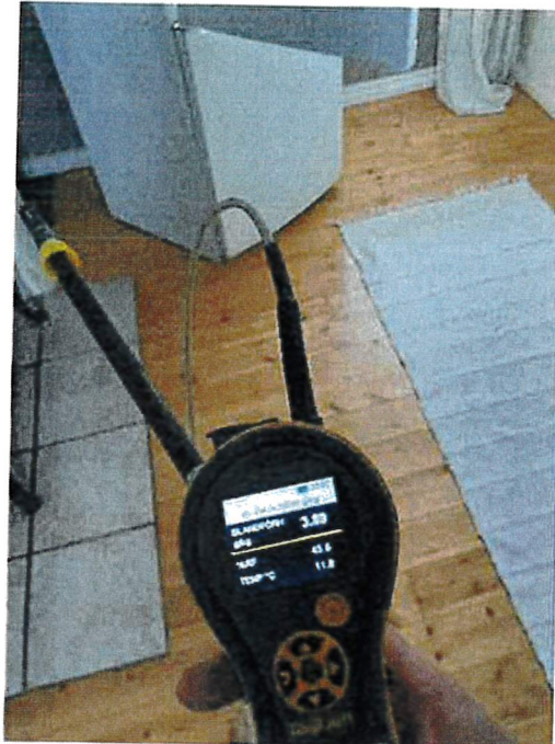
Kök Mätning temperatur samt relativ fuktighet
