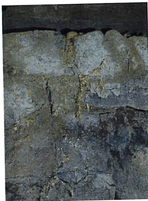
Husgrund Organisk isolering på grund
