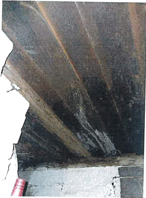
Kök Innertak bedöms som behandlat bakom kylskåp i kök
