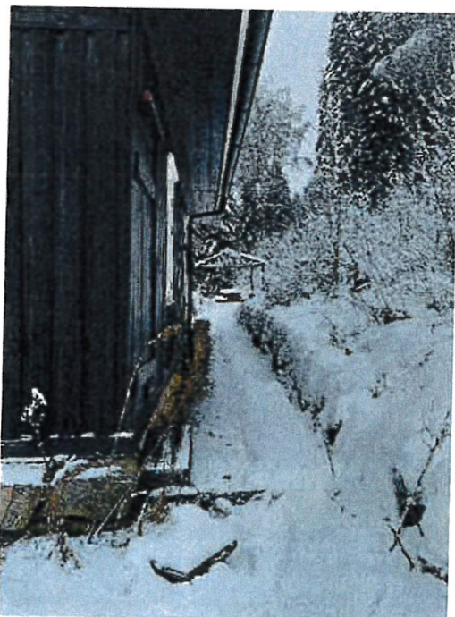
Utvändigt Stark sluttning förekommer mot bostad
