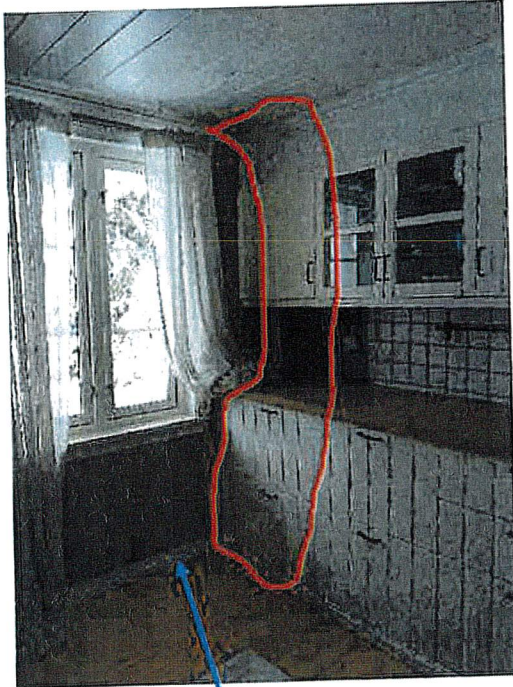
Kök Avvikande lukt förekommer vid golv/väggvinkel. Tak samt vägg öppnas upp enligt röd markering.
