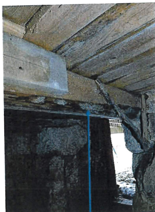
Grund Mikrobiell påväxt bedöms förekomma på trossbottenbrädor/bjälklag
